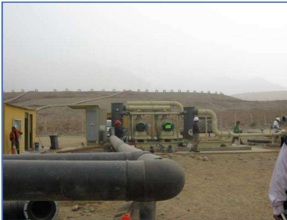
Imagen N° 3.4: Estación de tratamiento de biogás antes de empezar su operación
