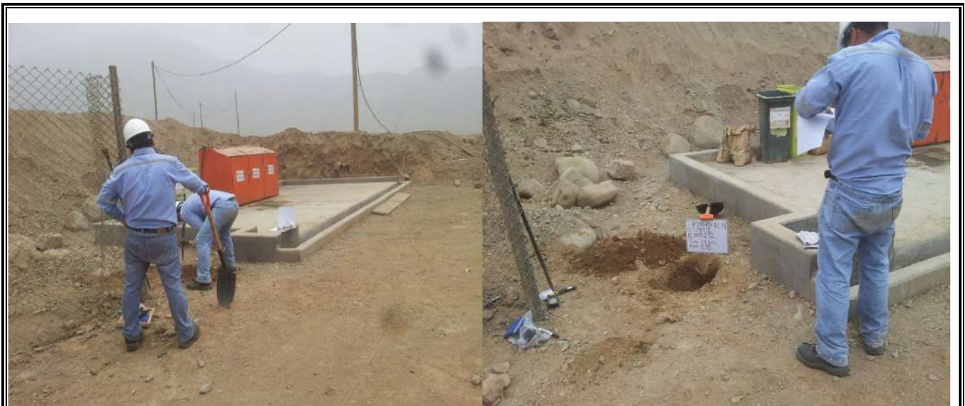
FOTOGRAFÍA S4: VISTA DEL ALMACEN DE RESIDUOS PELIGROSOS Y TOMA DE MUESTRA
