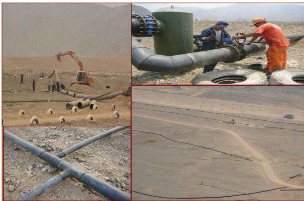
Imagen N° 3.10: Red de tuberías en el relleno Sanitario Huaycoloro
